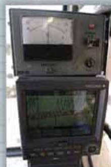
施工管理装置
