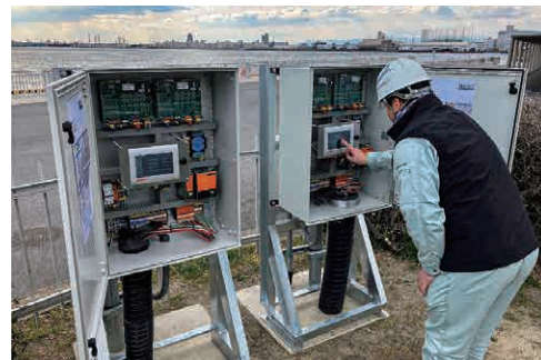
監視・制御状況
