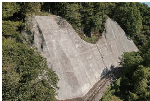
老朽化した鉄道法面での事例
