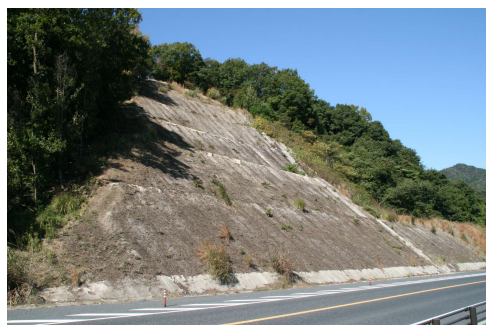
施工前（獣害で裸地化した法面）
