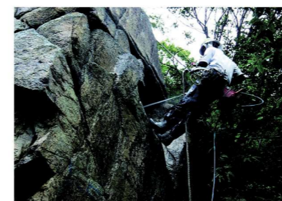
施工対象物の洗浄 浮石・土砂・木根を除去し、高圧洗浄機で附着物を洗浄
