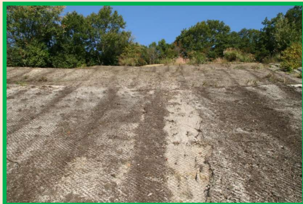
■■ 生育基盤が流亡した法面 ■■
