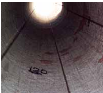
クラック、剥離状況の観察
