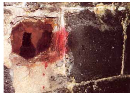
鋼板面の腐食進行状態
